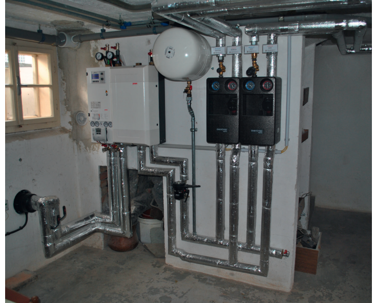
Neue Übergabestation; © Bäuerliche Biowärmelieferungs-genossenschaft Irdning eGen
