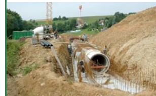
Baustellen tragen laut Umweltbundesamt österreichweit rund 8% zu den gesamten PM10-Emissionen bei.
