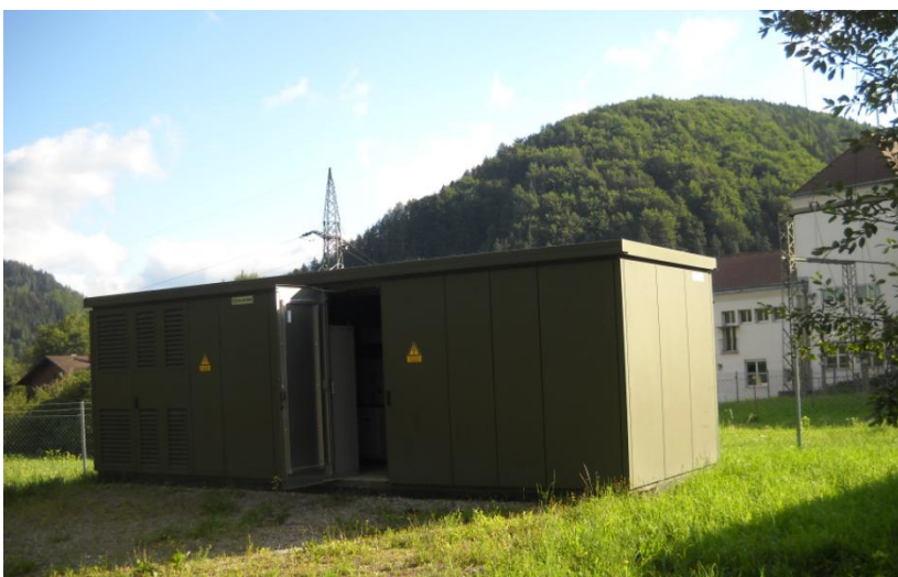
Abbildung 20: Übergabestation UW Mürzzuschlag
