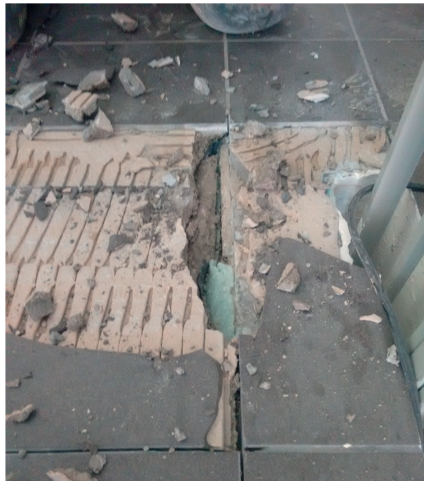
Nicht ordnungsgemäß ausgeführte Trennfuge in einem Stiegenhaus. (Quelle: ABT 15, Referat Lärm- und Strahlenschutz) © Günter Adler
