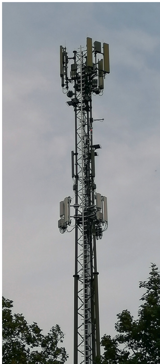
Sendeanlage mit Antennen für 2G-, 3G-, 4G- und 5G-Mobilfunksysteme. Die 5G-Antennen im unteren Sendersegment zeichnen sich durch die geringere Einbauhöhe aus. © Ewald Plantosar
