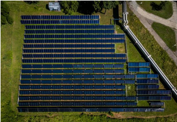
Abbildung 10: Teilfläche der größten Solaranlage Österreichs (Bildquelle: Picfly.at)
