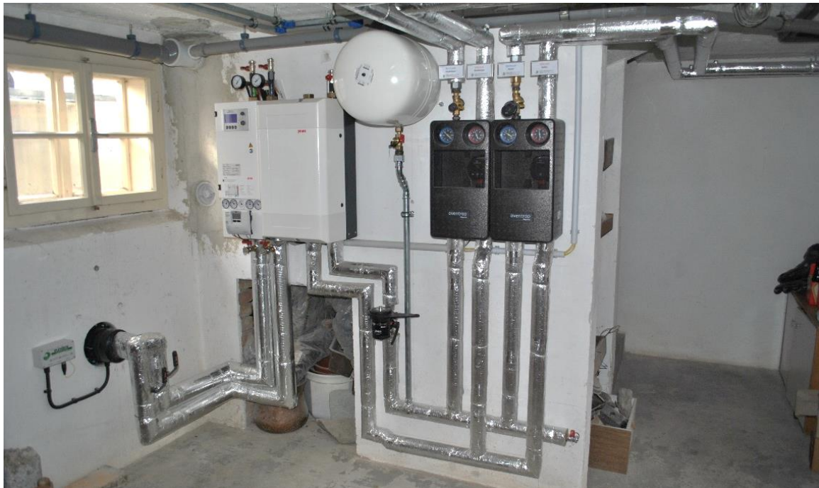
Abbildung 2: Neue Übergabestation © Bäuerliche Biowärmelieferungsgenossenschaft Irnding eGen
