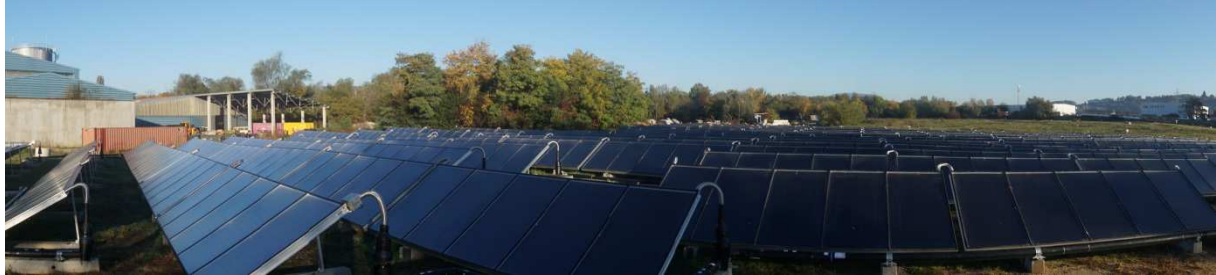
Abbildung 15: Solares Speicherprojekt Helios der Energie Graz (Quelle: AEE INTEC)
