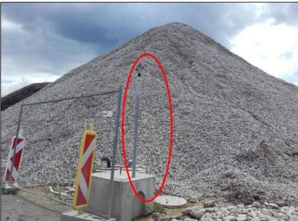
Abbildung 54: Ein Teil der Befeuchtungsanlage (rot markiert) im Bereich der Lagerflächen. (11.10.2017)
