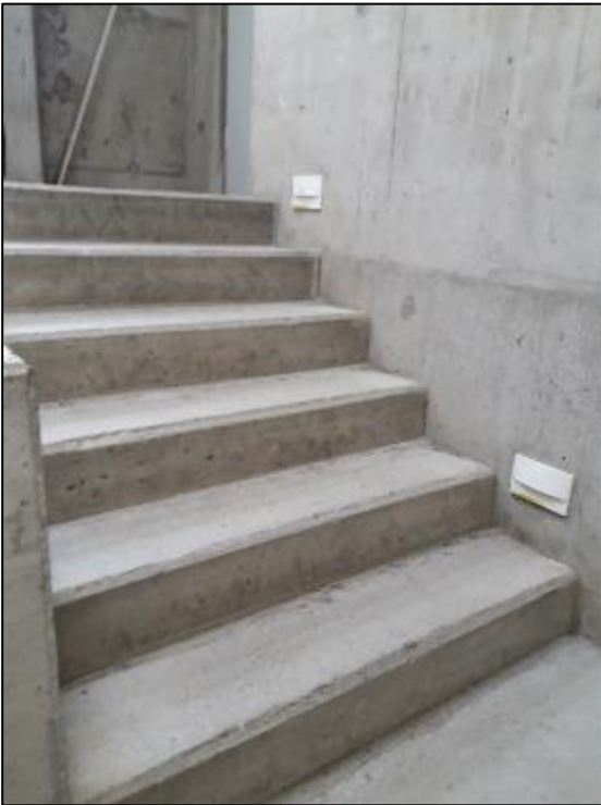
Abbildung 67: Bedarfsabhängige seitliche Nottreppenbeleuchtung an den Fluchtwegen (04.03.2020).
