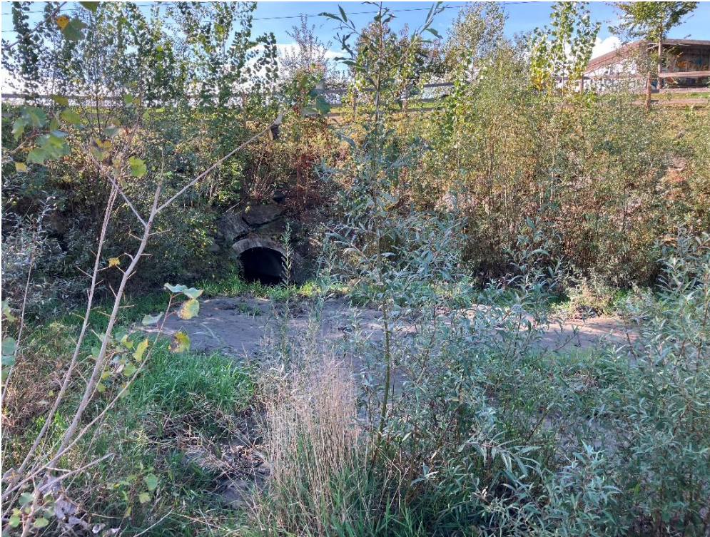
Abbildung 144: Durchlass zum Aubiotop, mit verlandeter Sohle (Foto: 08.10.2024)
