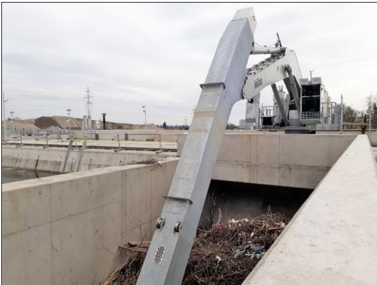
Abbildung 65: Die vollautomatisierte Rechenreinigungsmaschine mit der Rechengutgrube im Vordergrund. Das Rechengut wird bei Bedarf aus der Grube entfernt und entsorgt.
