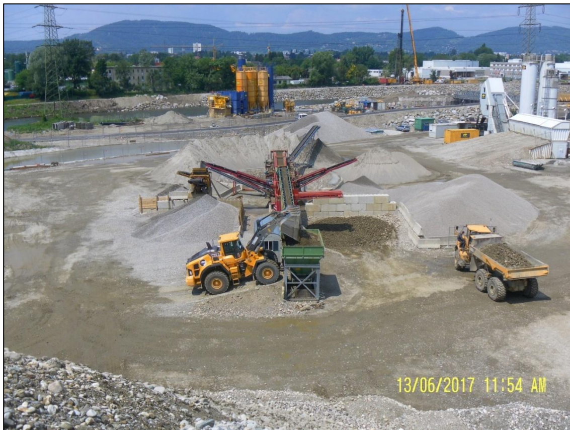
Abbildung 88: Aufbereitungsanlage (Foto vom 13.06.2017)
