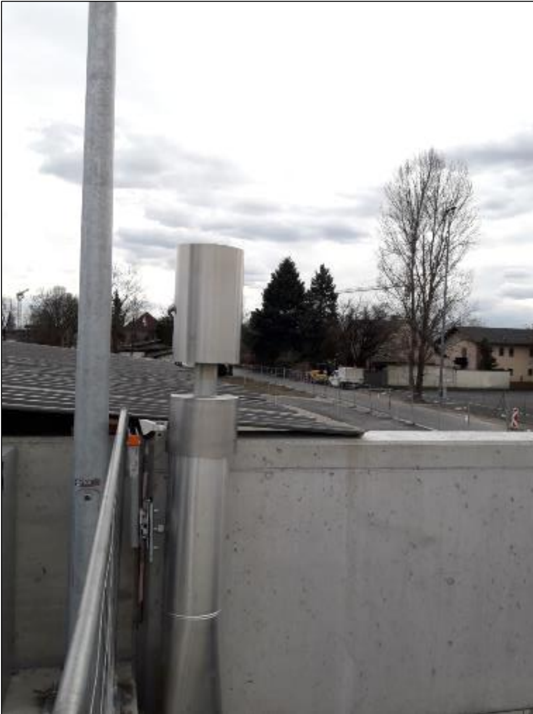
Abbildung 58: Die Abgasführung des Notstromaggregates erfolgt direkt ins Freiland und befindet sich außerhalb des Zugriffsbereichs von Personen.
