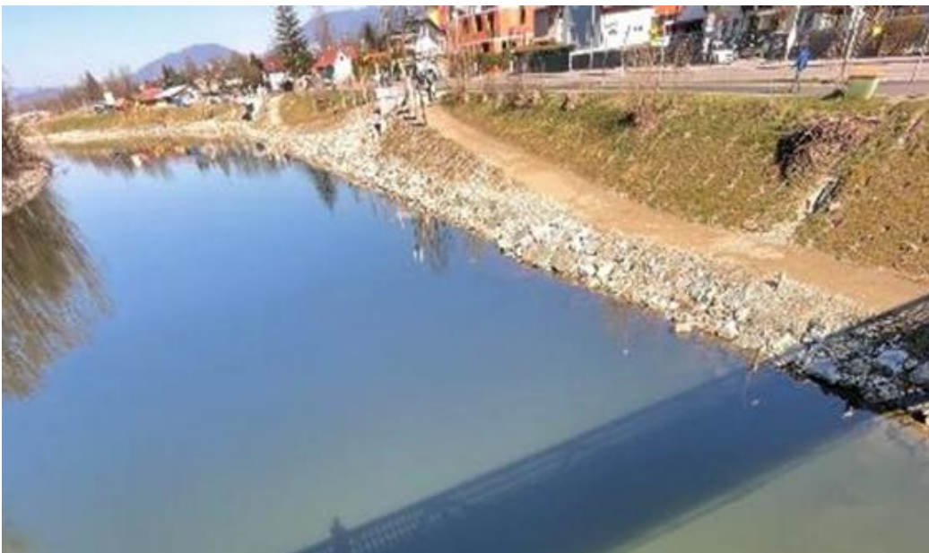
Abbildung 89: Blickrichtung Norden, linkes Murofer, südlich der Puntigamer Brücke (Foto: März 2021)
