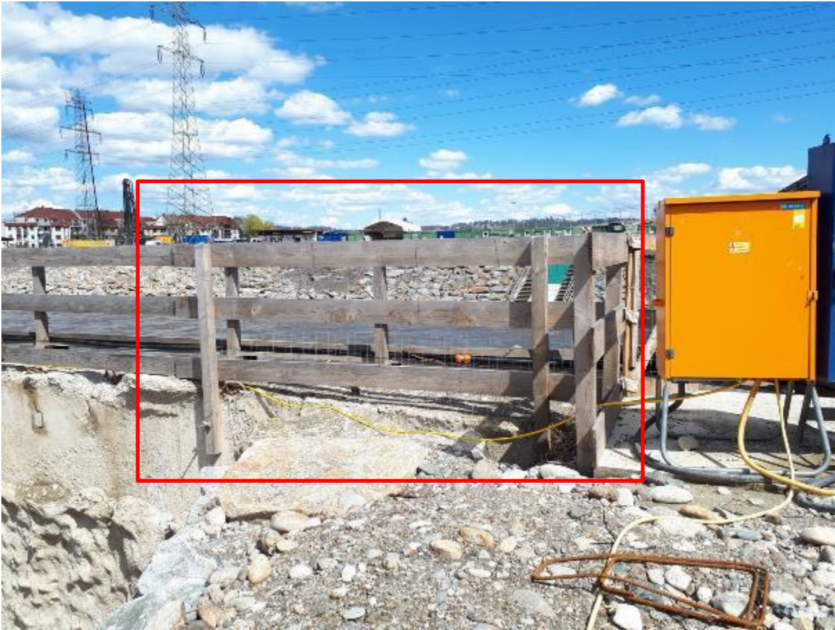
Abbildung 94: Südlicher Zugangsbereich zur Schmalwand. Es wurde ein zusätzlicher, fischotterdichter Schutzzaun angebracht (Foto: 11.01.2018)
