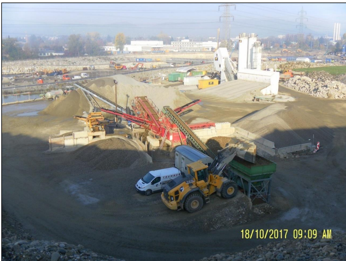
Abbildung 87: Aufbereitungsanlage (Foto vom 18.10.2017)
