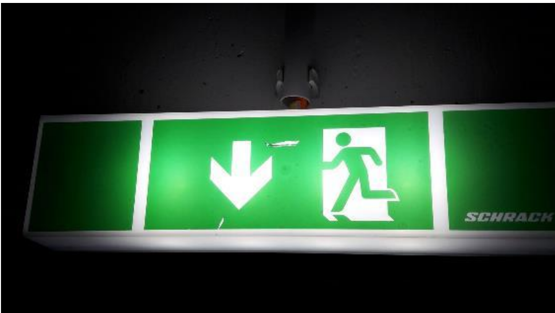
Abbildung 68: Die kombinierte Fluchtwegbeschilderung und -beleuchtung im Murkraftwerk ist bei Netzausfall notstromversorgt (04.03.2020).
