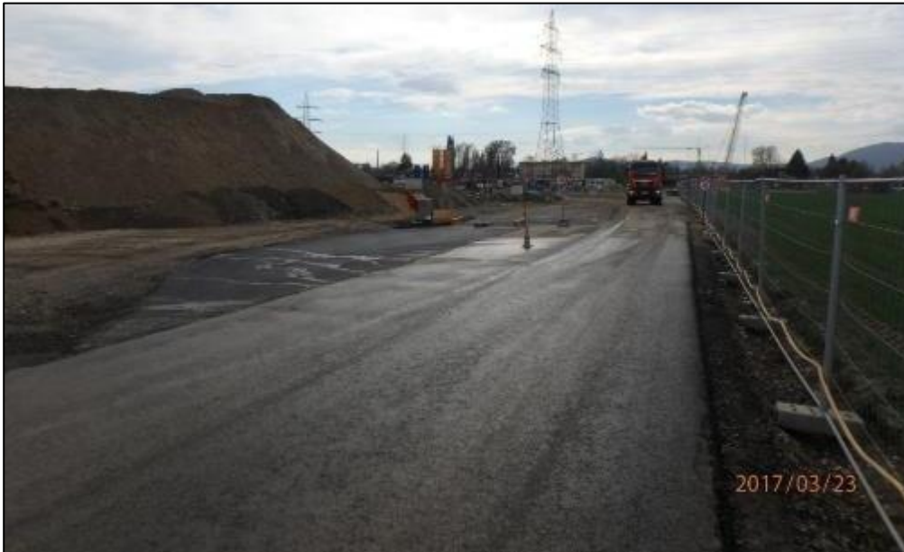
Abbildung 55: Foto der eingebauten Reifenwaschanlage im Bereich Zufahrt Ziehrerstraße. (23.03.2017)
